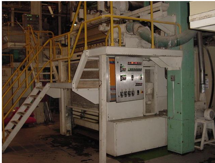
Foto1: planta de alimentos, panel de control
